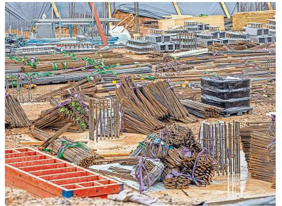
Das Metall, das auf der Baustelle an der Carl-Hölzle-Straße verteilt liegt, ist für die Gleitschalung gedacht.
