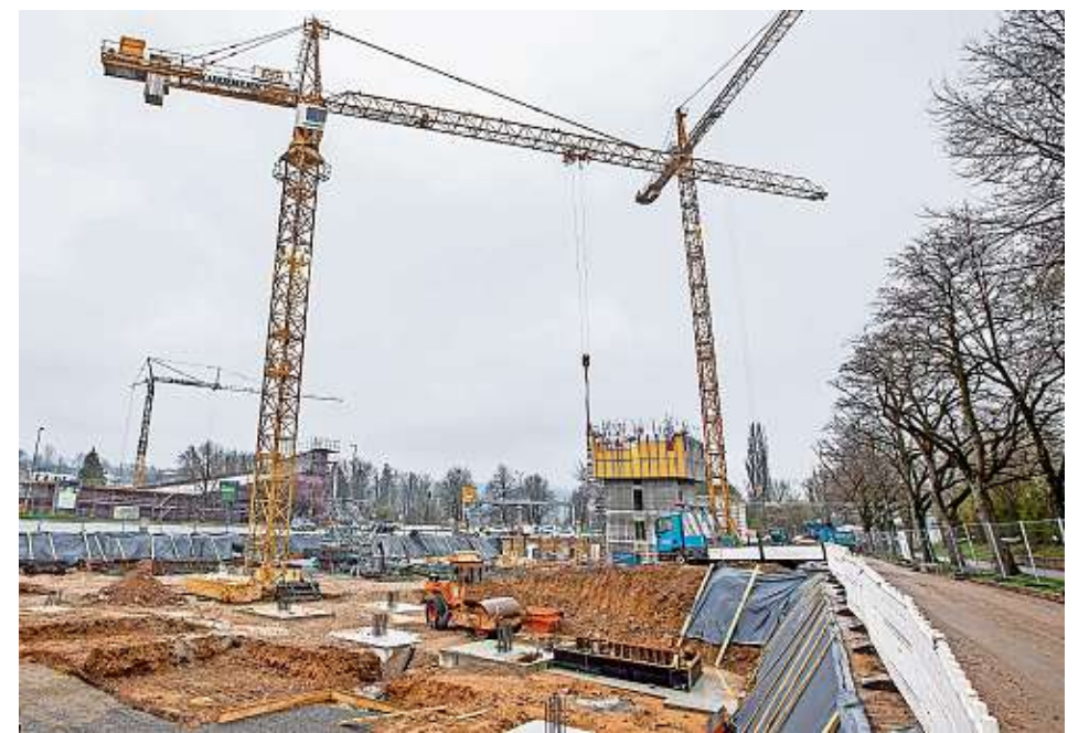
Zwei Kräne überragen deutlich sichtbar die Baustelle: Der Bau des Hochhauses Carl ist eine komplexe Aufgabe.
