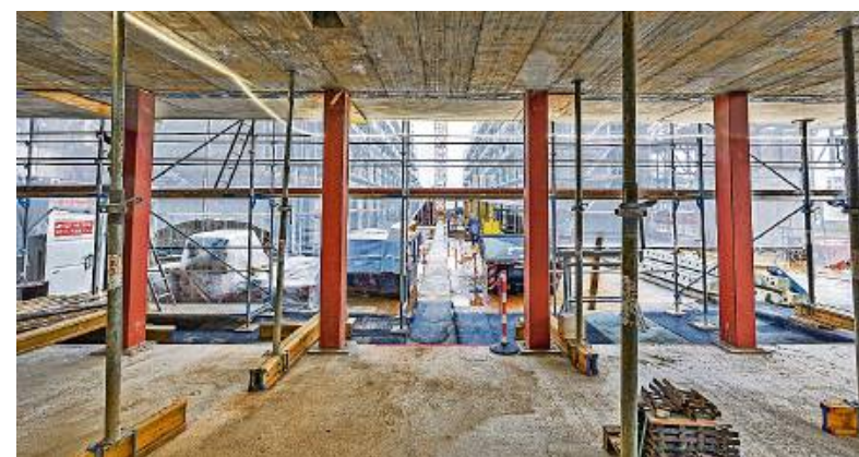
Das Treppenhaus des Hochhauses besteht aus einem Betonkern. In die Holzrahmenbauwände sind Stützen integriert.
