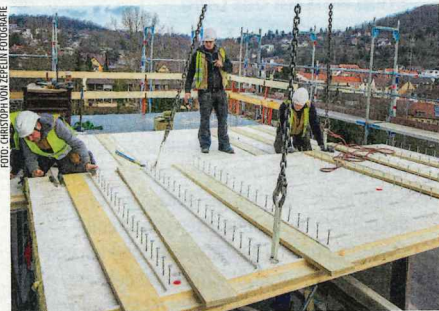
Allein in den Decken werden rund 375 Kubikmeter Holz aus dem Pforzheimer Forst verbaut.
